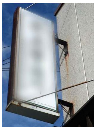
老朽化している事例
