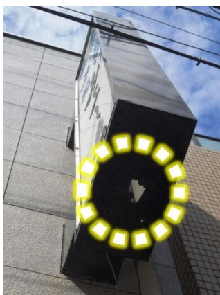
破損が見られる事例
