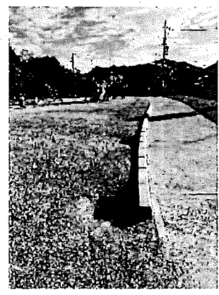
真上町中央公園 ●雨水の排水対策
